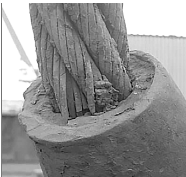
Abb. 3: Drahtbruch an einer Seilendverbindung
